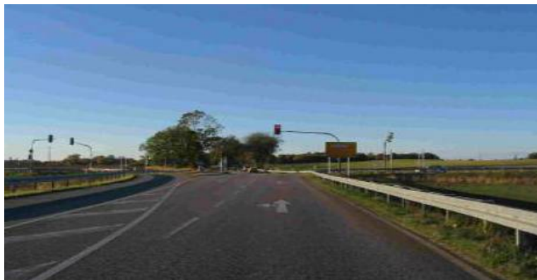
شکل 3-2: تقاطع فقط از فاصله 100 متری قابل مشاهده است؛ خطر وقوع تصادف در اثر سرعت بالا و ترمزگیری پیش‌بینی نشده
