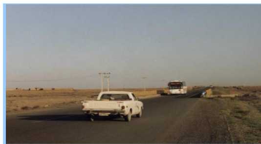
کاهش پرخاطر عرض راه در محل پل
