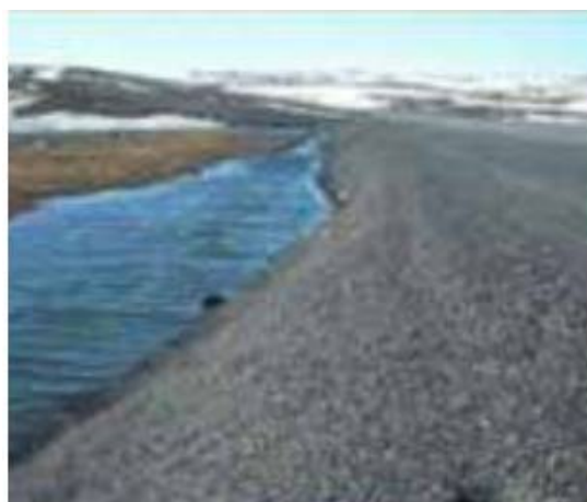
شکل ۴ - شکسته شدن سیستم زهکش باند فرودگاه
