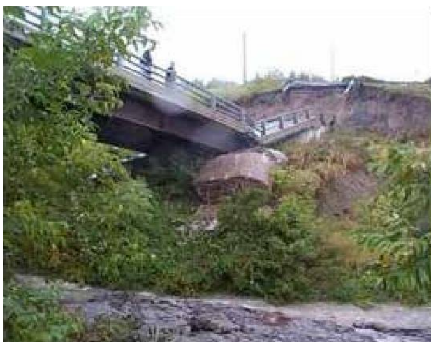
شکل ۲- چرخش عمیق لایه‌های خاک و خسارت به پایه‌های پل، ۲۰۰۰
